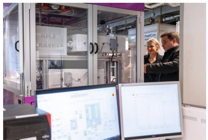
Bild 3: Demonstrationsanlage mit SOFC-Stack und Nachbrenner (TOX).
